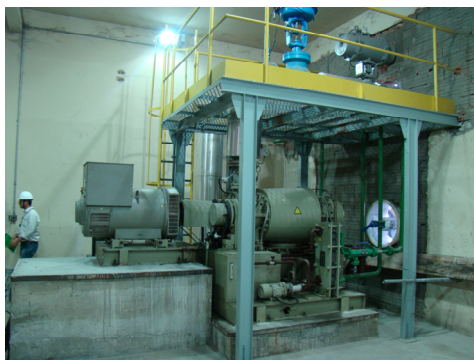
Figura 2- Gerador Helicoidal instalado
