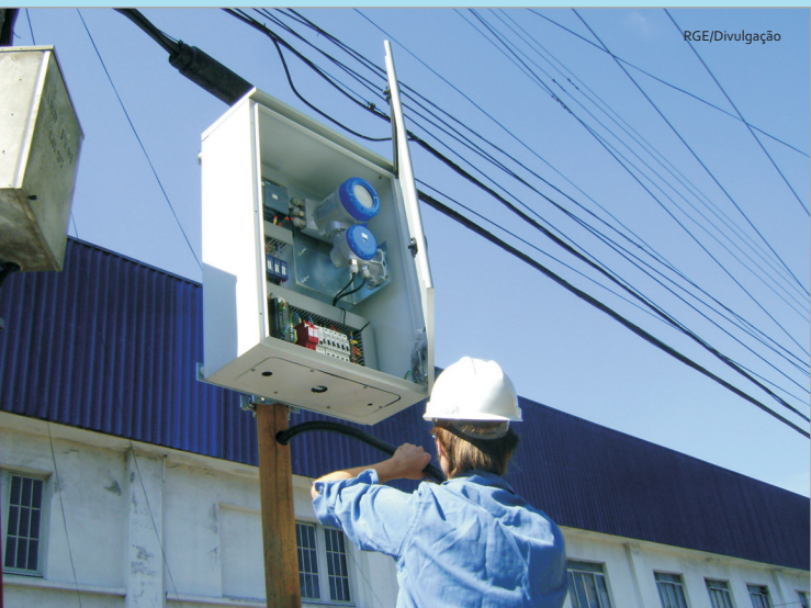
RGE automatizou fluxo de água
